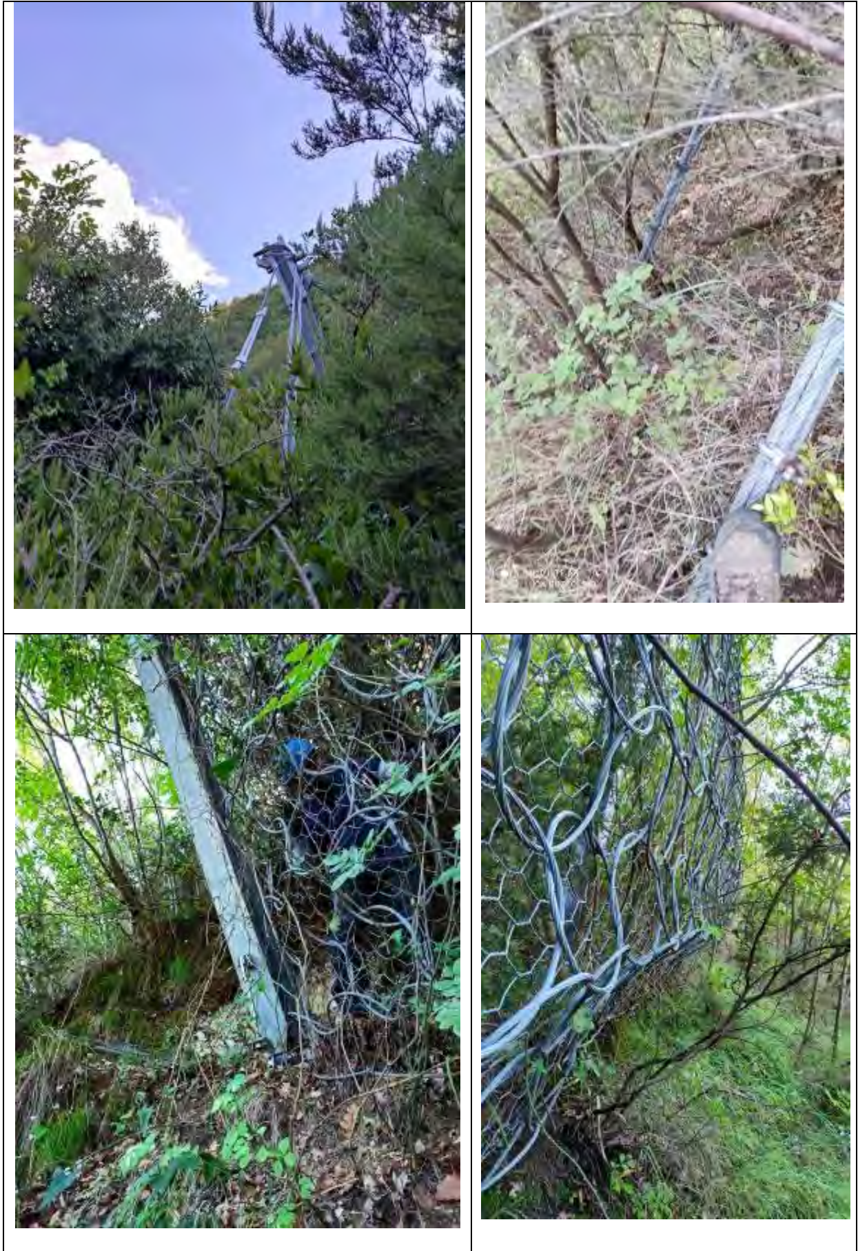
Foto 109. Dettagli barriera paramassi a quota circa 345 m slmm
